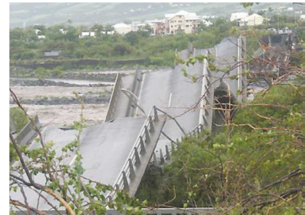
Ile de la Réunion - Pont sur la rivière Saint-Etienne suite au passage du cyclone Gamède en 2007
