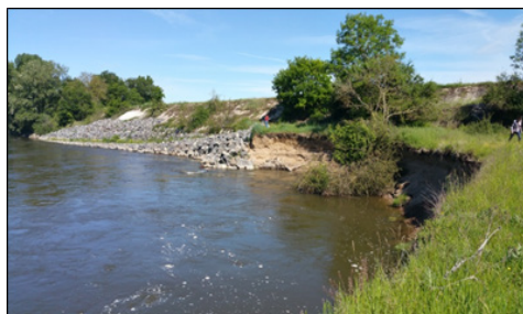
Digue St Loup : Nouvelle zone d'affouillement en amont de la zone confortée en 2015
